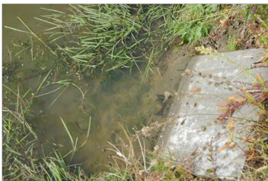
Abb.36: Der Ausgang einer Drainage liegt unter Wasser. Das Wasser von den Äckern kann dadurch nicht ablaufen.
